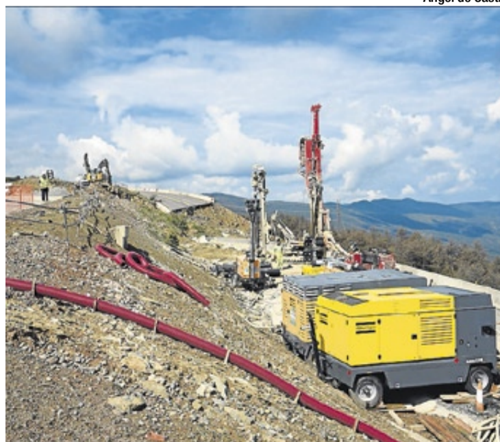
El tramo hundido. Las máquinas arreglan la carretera destruida.
